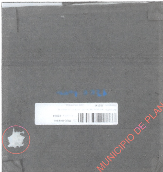
Foto 5 – Detalhe do empolamento e deslocamento
